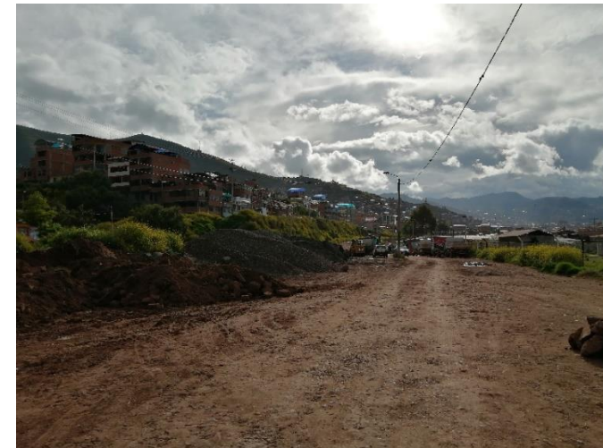
Imagen N° 43: Acumulación de escombros en el área de aporte del PPJJ General Ollanta
